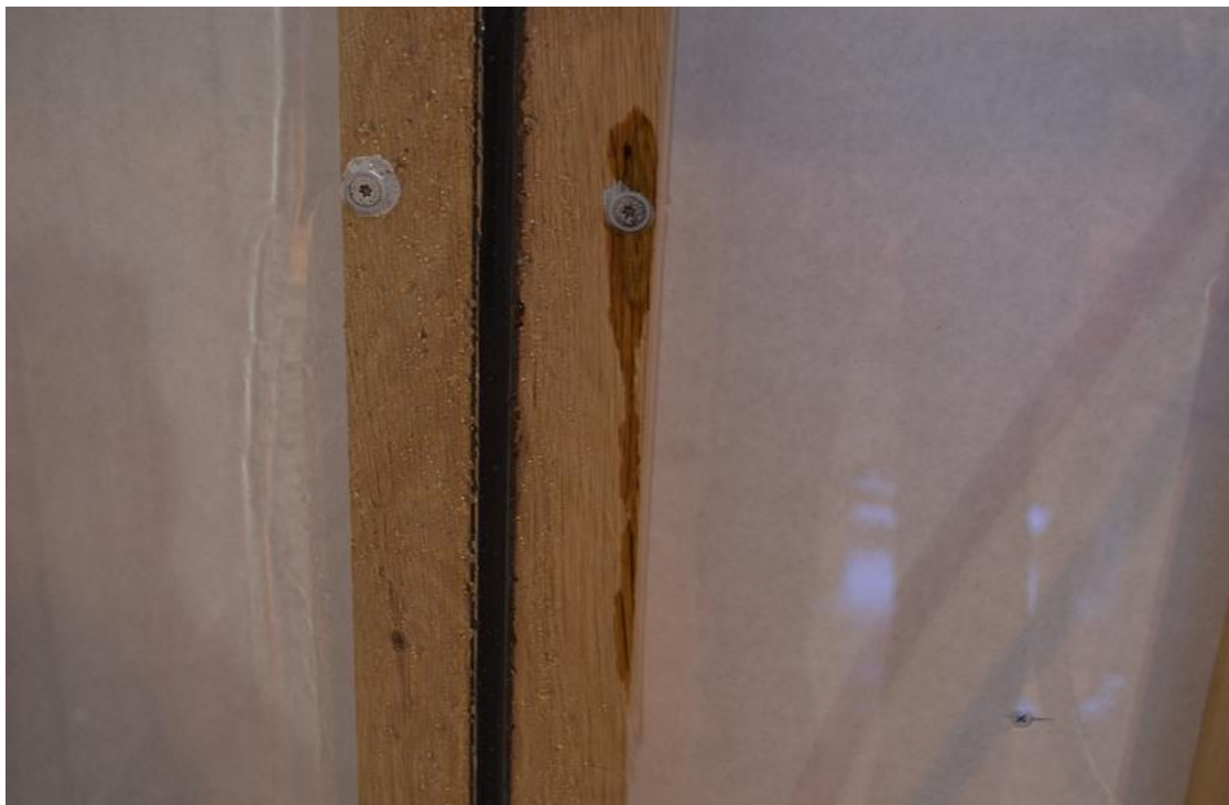
Bild 17. V ägg 2, läckage vid skruv.
