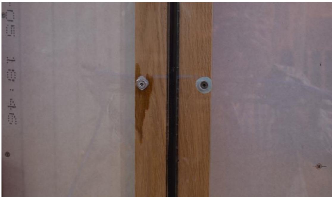
Bild 18. V ägg 2, läckage vid skruv på bytt glaspanel.
