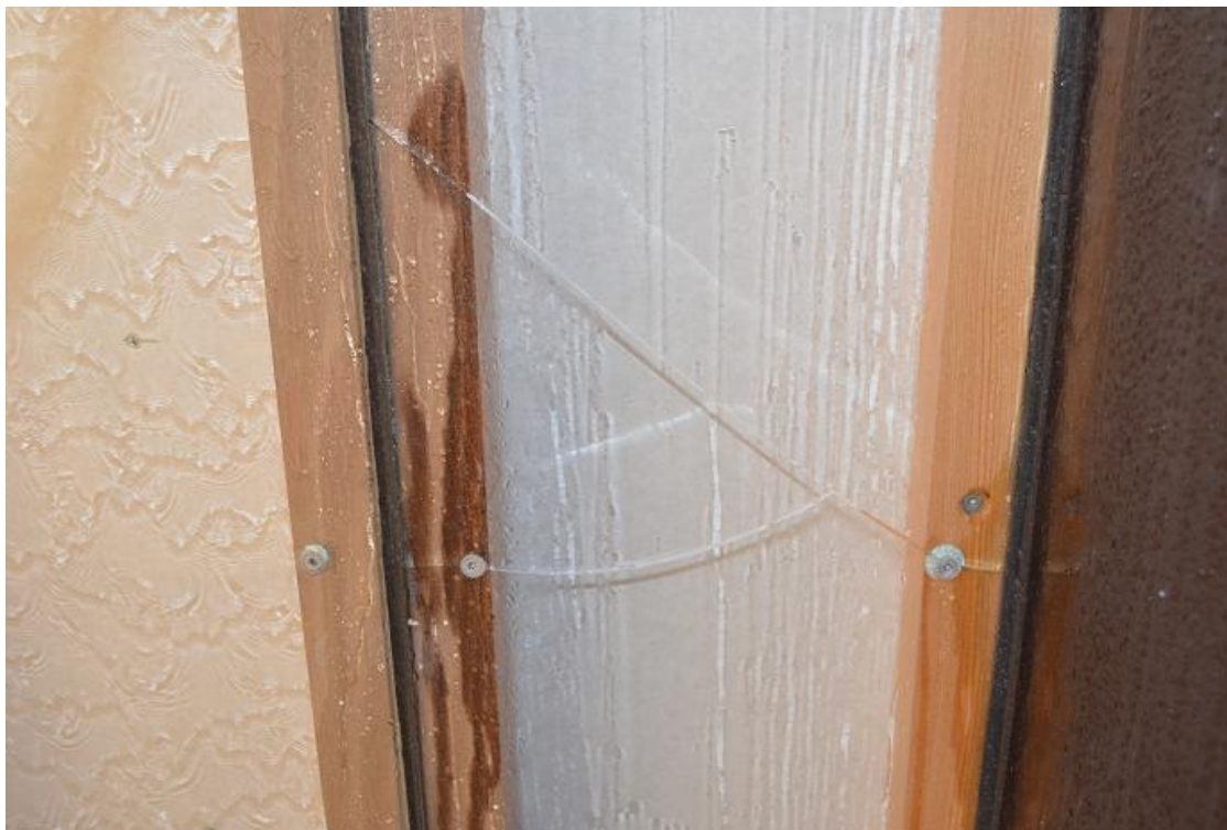
Bild 21. Väg 2, spricka 6, uppstod under den andra vattenbegjutningen.
