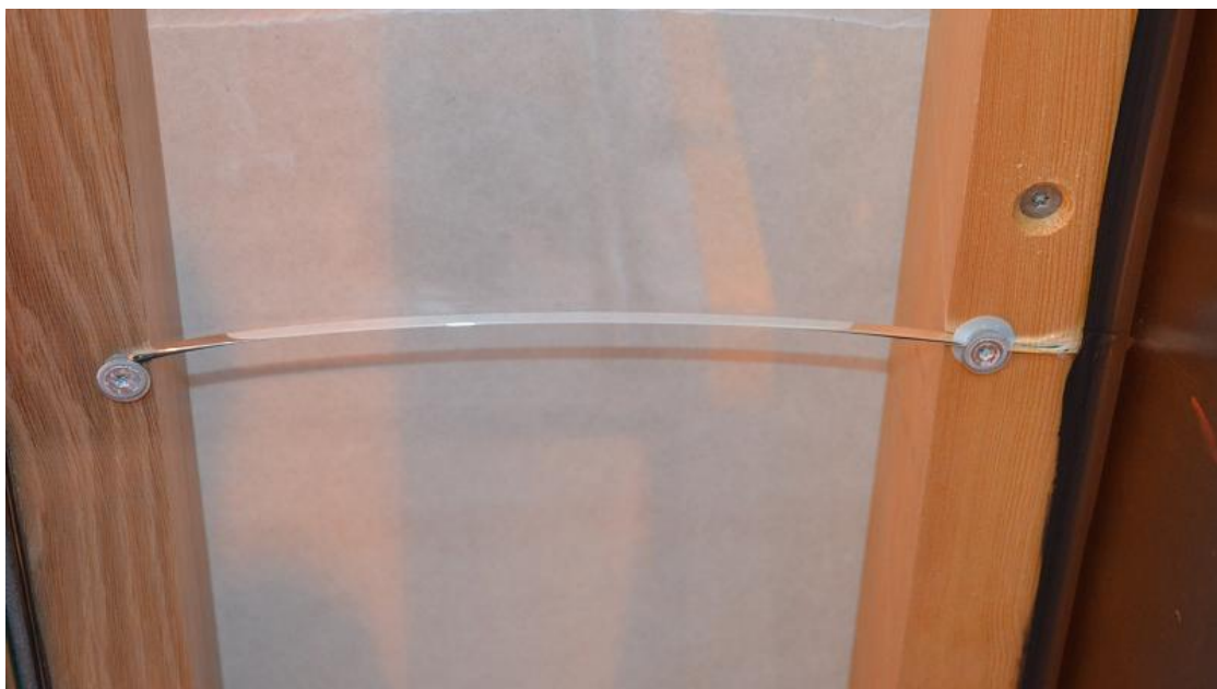
Bild 22. Väg 2, spricka 7, uppstod mellan vattenbegjutningarna.
