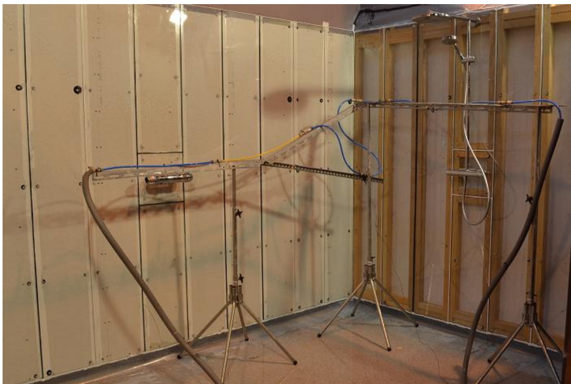
Bild 4. Provuppställning med monterade vattendysor.
