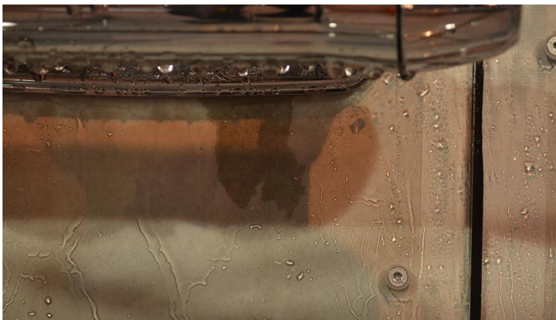
Bild 16. Väg 1, läckage vid blandarfäste efter start av vattenbegjutning.
