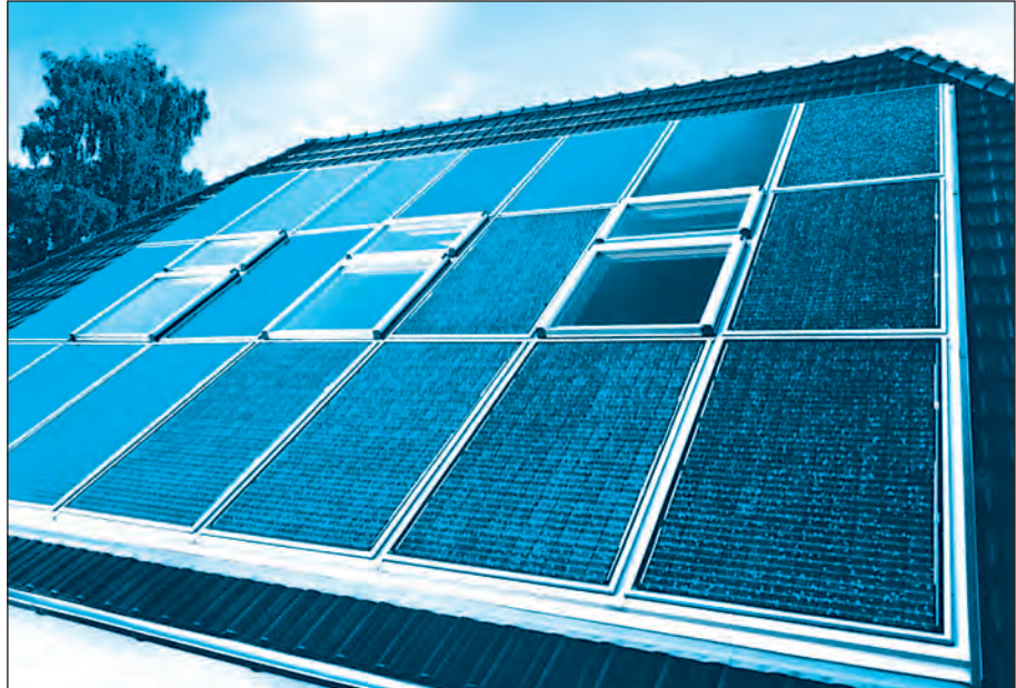
Bild 5. Solcellsmoduler som helt tak.
